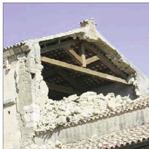
Il timpano danneggiato dal terremoto
